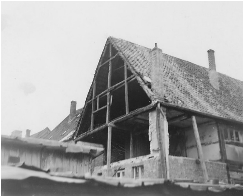
An der Hofseite des Hauses Marktstraße 4 lässt die neue Eigentümerin Luise Neitzel 1955 die im Februar 1945 entstandenen Bombenschäden beseitigen.
